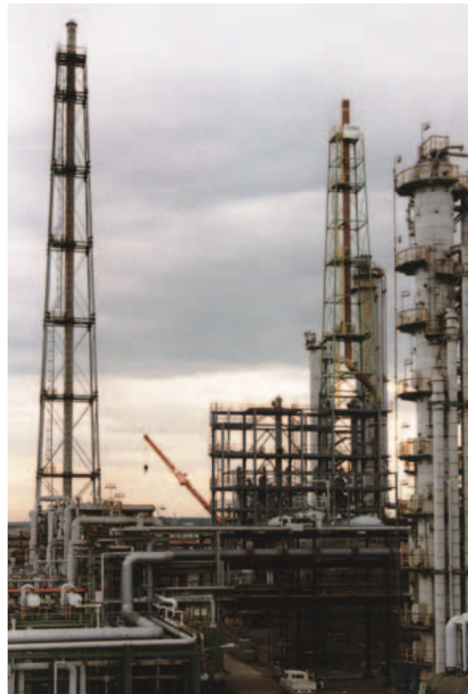
Blick auf die Revamp-Methanolanlage
