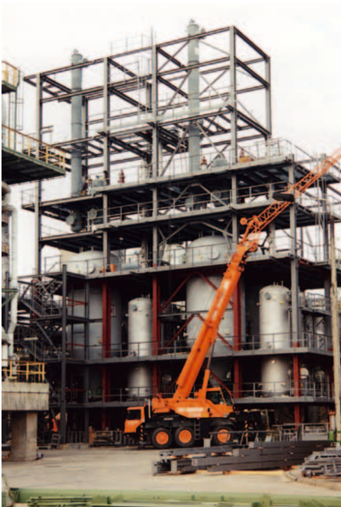
Die Revamp-Methanolanlage in Leuna
