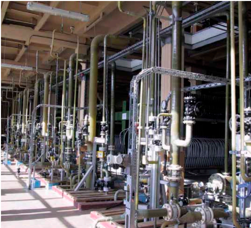
Teilansicht der Chlorelektrolyseanlage in Navoi
