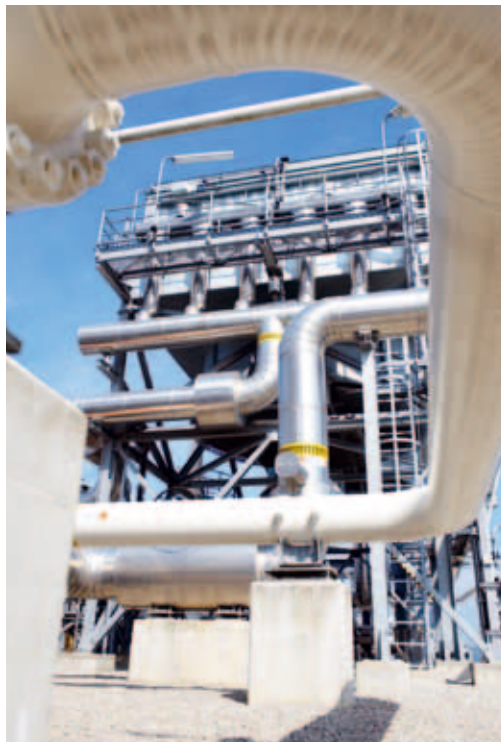
Erdgasuntergrundspeicher Haidach II
