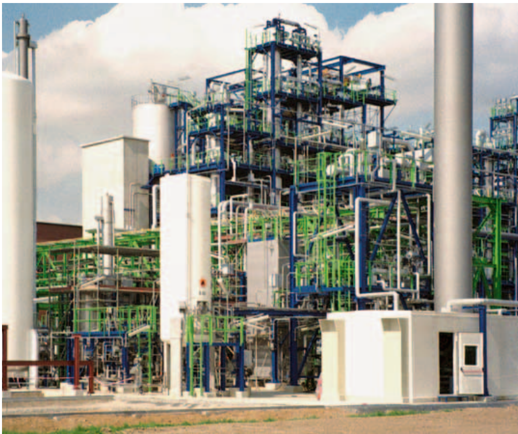
Blick auf die Carbonsäurederivateanlage in Lülsdorf
