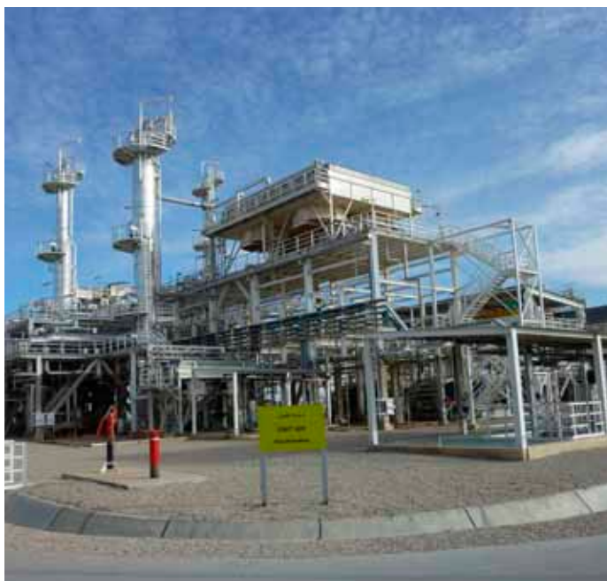
Fraktionierung in der Gasaufbereitungsanlage in Palmyra/Syrien
