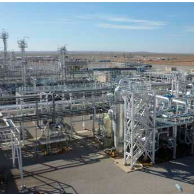
Teilansicht der Gasaufbereitungsanlage Syrien
