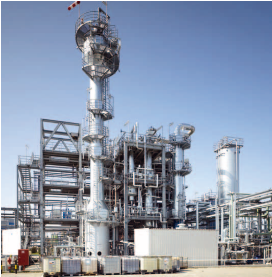
Die Anlage zur Altölaufbereitung in Dollbergen
