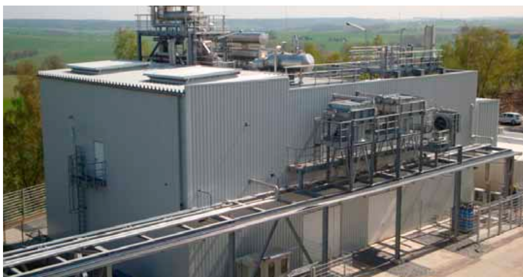
Benzinanlage in Freiberg
