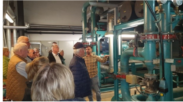
Erläuterungen im Kältemaschinenraum
