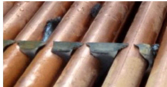
Bild 3: hier kam es durch eingespülte eisenhaltige Schweißschlacke zu Lochfraß an den Kondensatorrohren.
