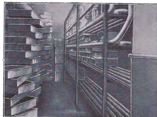
Fig. Nr. 24 Härteraum für die Sahneisbereitung — 25° für eine Konservenfabrik
