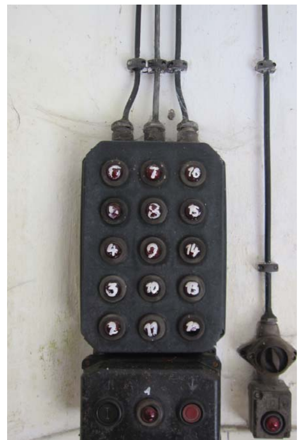
SCHALTANLAGE FÜR KARUSELL
